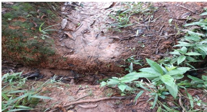
Figura 19. Erosão no Camping do Mágico.
