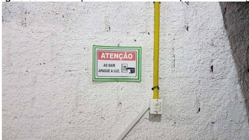
Figura 36 – Sinalização visando diminuir desperdício de energia
