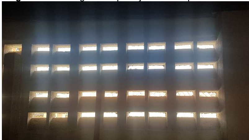
Figura 24 – Cobogós sem proteção no estoque de material
