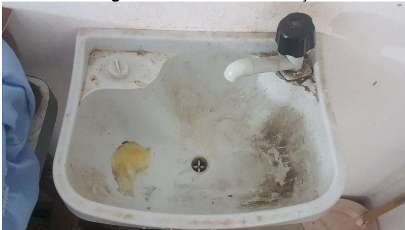
Figura 29 – Pia do banheiro suja
