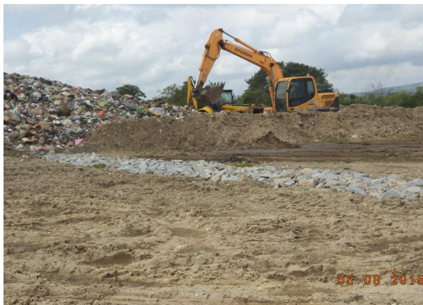
Figura 2. Drenagem de Percolados. (Fonte: Dados da Pesquisa)
