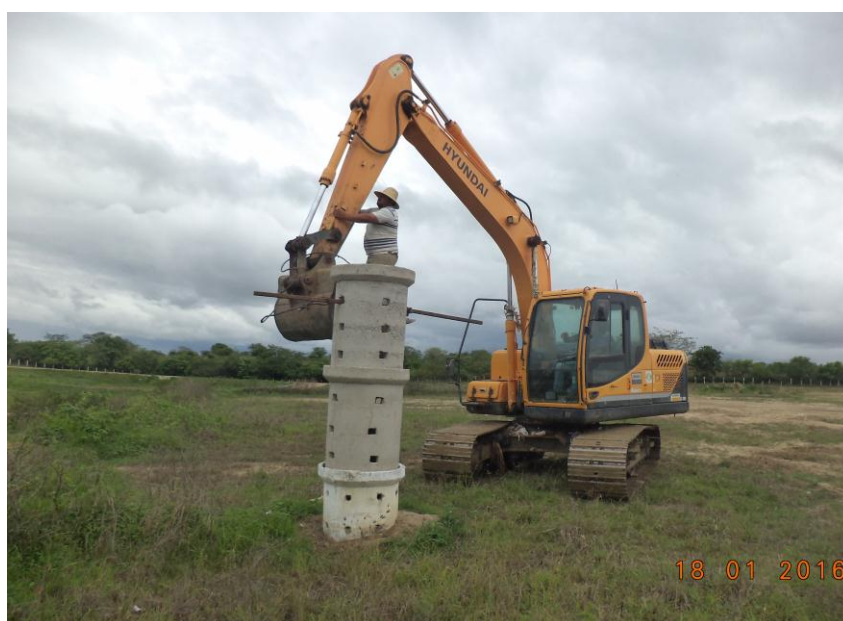
Figura 3. Drenagem do Biogás (fonte: Dados da Pesquisa)
