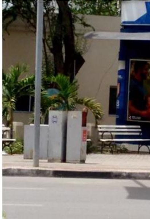
Figura 5 – Coletor da via Avenida Oswaldo Cruz.
