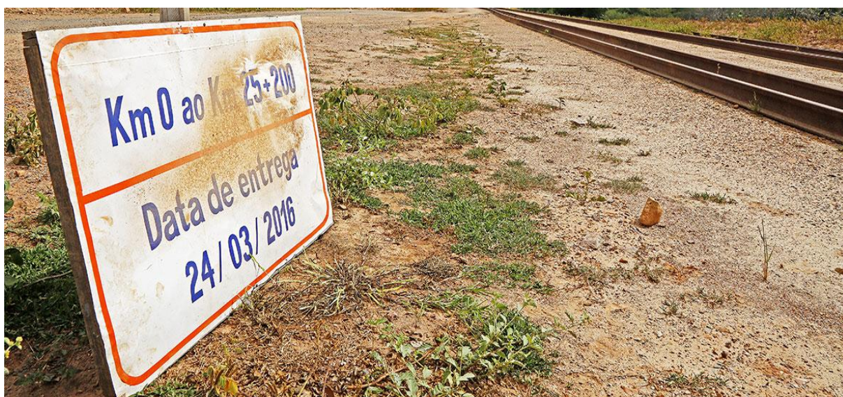
Trecho da obra inacabado em Missão Velha (CE)
